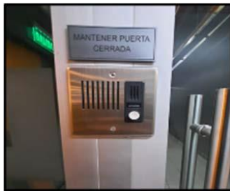
CITOFONO HALL SUBTERRANEOS
