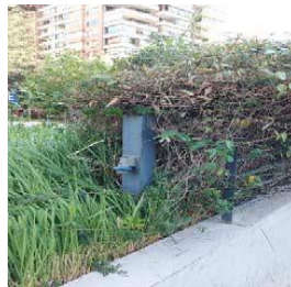
RED INERTE TOMA EXTERIOR
