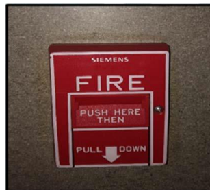
PALANCA DE INCENDIO
