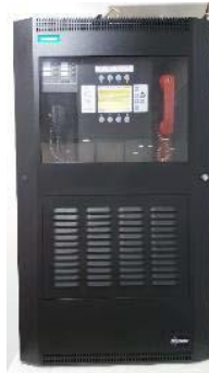
CENTRAL DE INCENDIO
