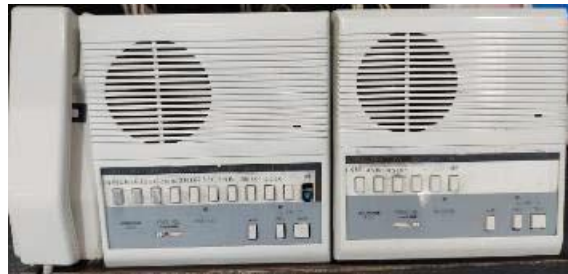
CENTRAL DE CITOFONÍA RECEPCIÓN
