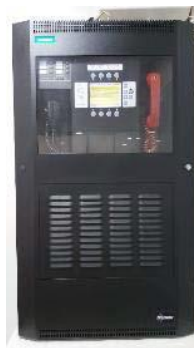
CENTRAL DE INCENDIO
