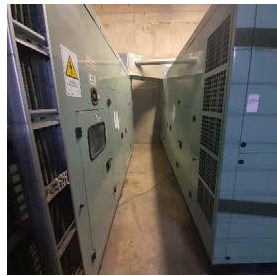
ACCESO A SALA GGEE
